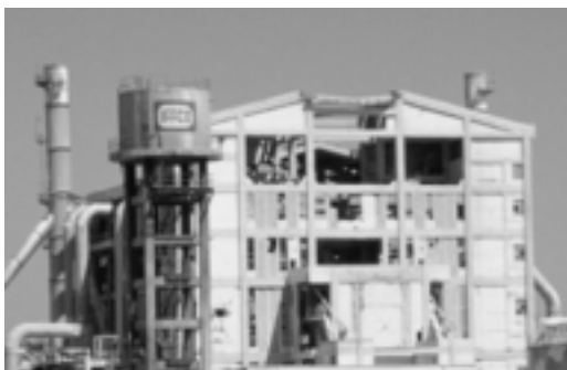
Bild 4: Stahlbetonrahmen der Produktionshalle von IFFCO mit herausgebrochenen Mauerwerkswänden
