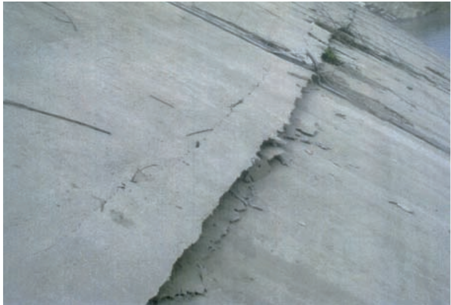
Bild 7: Schäden entlang der Horizontalfuge der Betonabdichtung des Zipingpu-Damms (Mai 2008)
