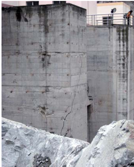
Bild 5. Futan: Schubriss (vermutlich durch Steinschlag) an einem der Wehrpfeiler.
