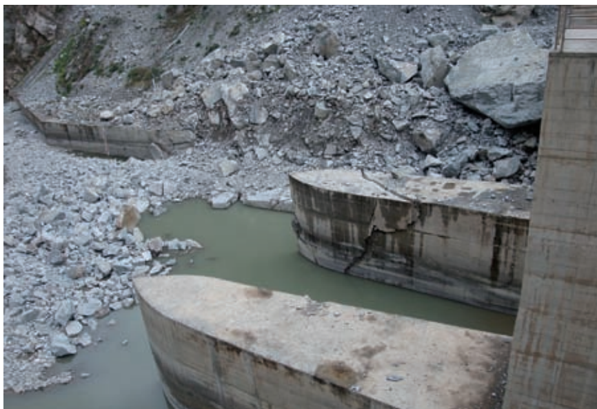
Bild 5: Abscheren des rechten Wehrpfeilers und Kippen der Seitenstützmauer eines Flusskraftwerks infolge Bergsturz (April 2009)
