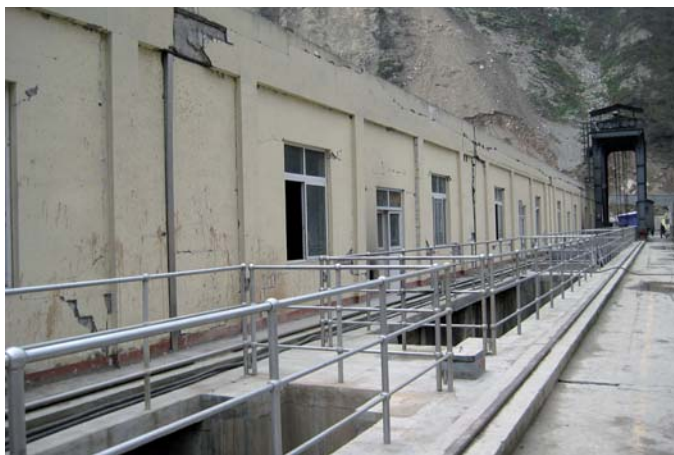
Bild 7. Wehranlage Yingxiuwan: Schäden am Wehrbauwerk.
