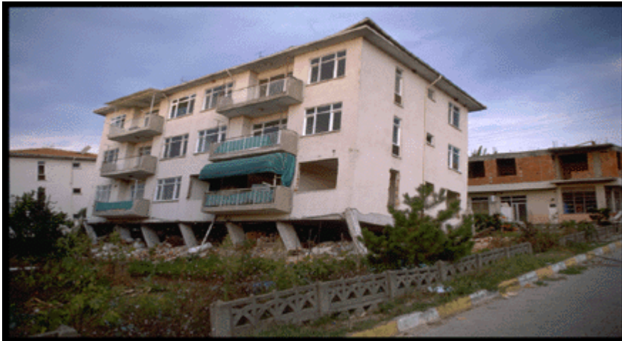
Bild 1 Totalschaden infolge eines zu schwach ausgesteiften Erdgeschosses ("soft storey"-Schaden)
