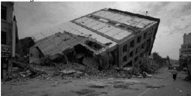
1. Umgekipptes mehrstöckiges Gebäude in Taiwan, September 1999
