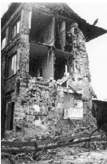
4. Typische Erdbebenschäden an Mauerwerksbau in Armenien 1988, Mauerwerksbauten sind in der Schweiz weit verbreitet, weisen jedoch ein sehr ungünstiges Erdbebenverhalten auf
