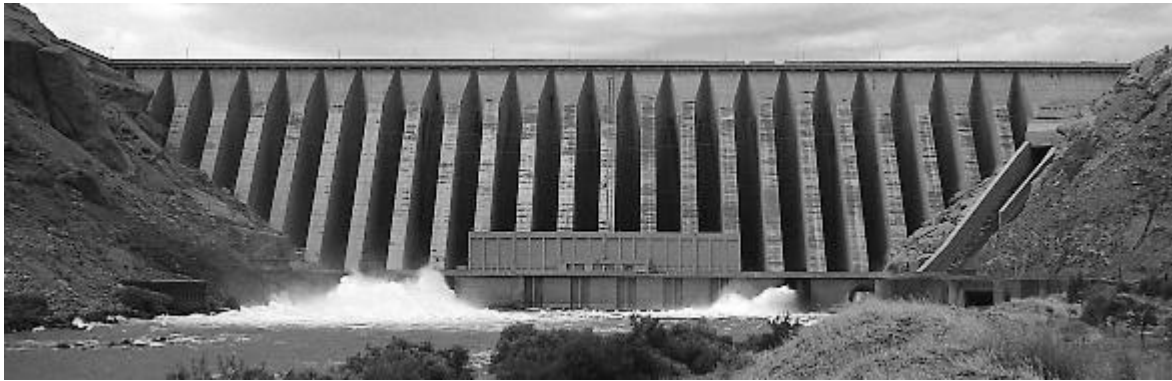
Fig. 2: Die 106 m hohe Sefid Rud Pfeilermauer wurde im Juni 1990 durch ein starkes Erdbeben beschädigt und der Stausee musste teilweise abgesenkt werden, rund 40'000 Personen kamen bei diesem Erdbeben durch Einsturz ihrer Wohnungen ums Leben, mehrere Talsperrenwärter kamen ebenfalls um und sämtliche Zufahrtsstrassen zur Mauer waren durch hunderte von Felsstürzen blockiert
